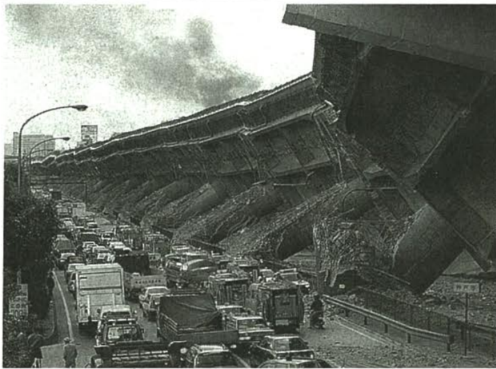
阪神大震災で倒壊した阪神高速道路神戸線 ＝1995年1月17日、神戸市東灘区深江南町
