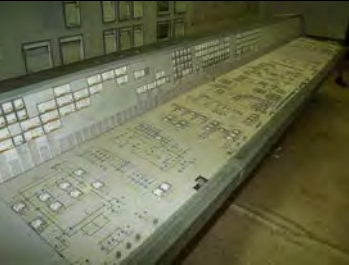
運転室の制御パネル
