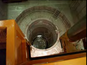
上部からみた圧力容器
